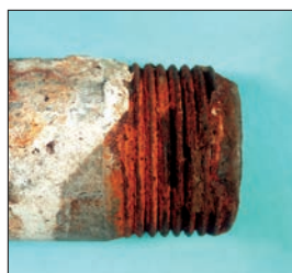
ねじが欠落したライニング鋼管
