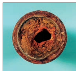
さびこぶが形成されたライニング鋼管
